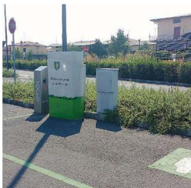
In centro. Le colonnine elettriche Lidl di via XXV Aprile
